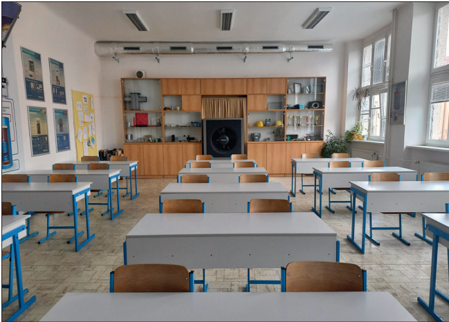
▲ Obr. 1 ● Přívod venkovního vzduchu do třídy
