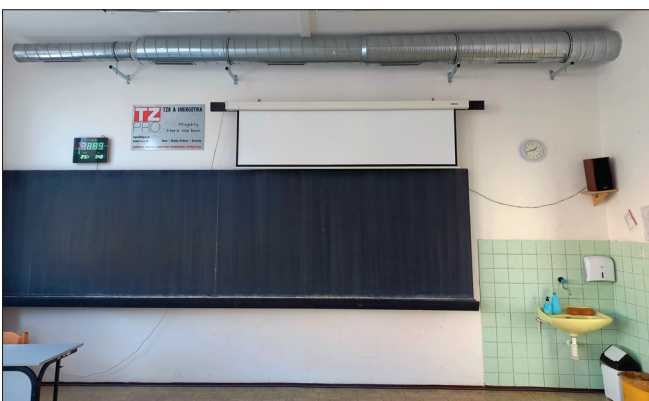
▼ Obr. 2 ● Odvod odpadního vzduchu ze třídy
